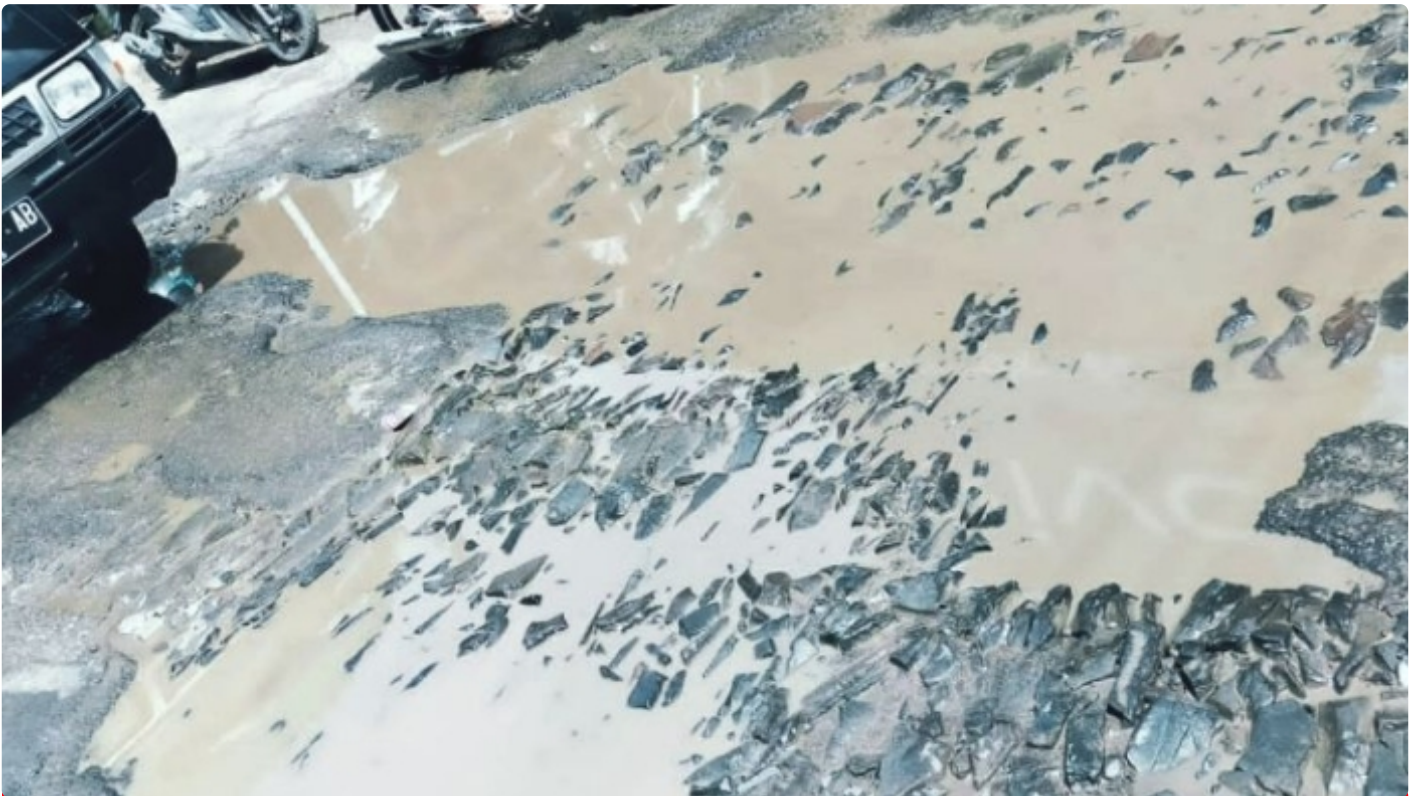
Terlihat jalan protokol Malingping rusak dan digenangi air
